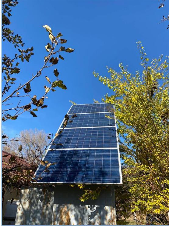
Resim 1. Güneş enerjisi ile yeraltı suyu sulaması
